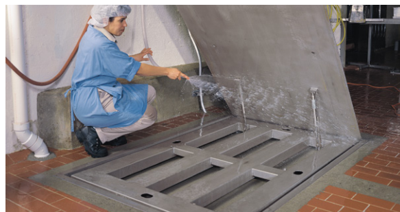
La instalación en un foso permite un acceso muy rápido a la báscula
